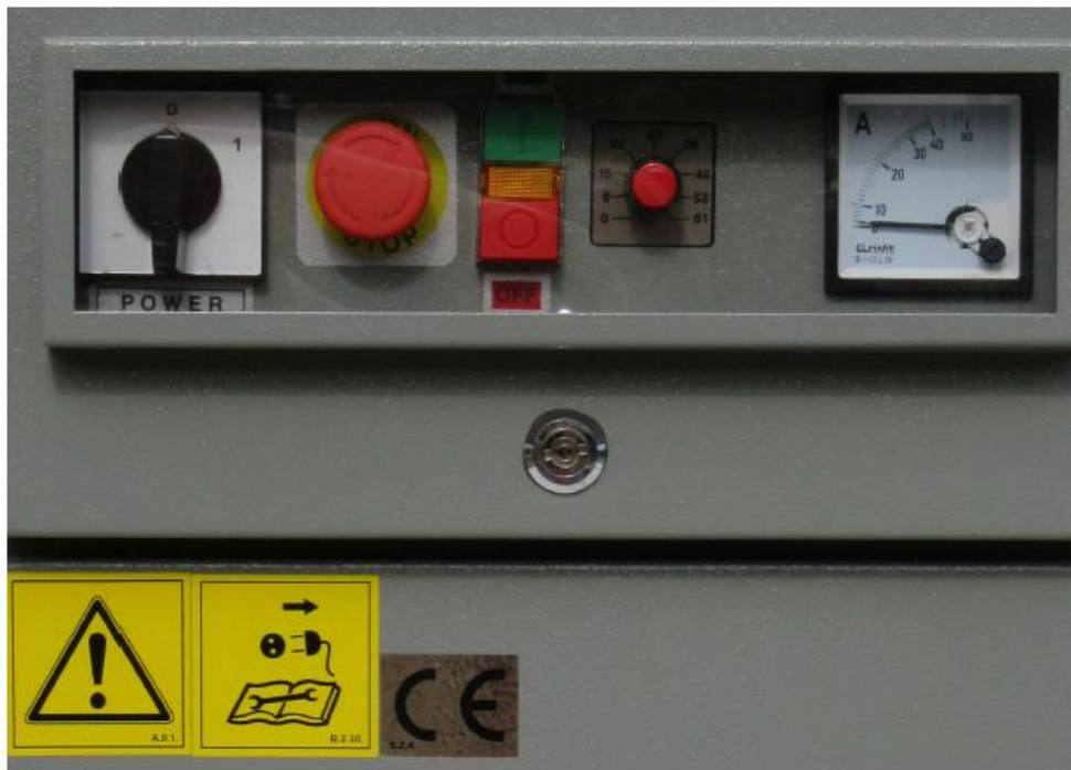
Kuva 2: Sähköinen ohjausyksikkö taajuusmuuttajalla
